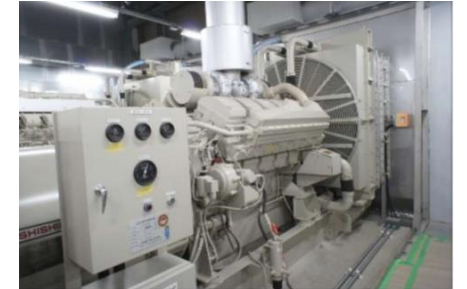
非常用電源設備
