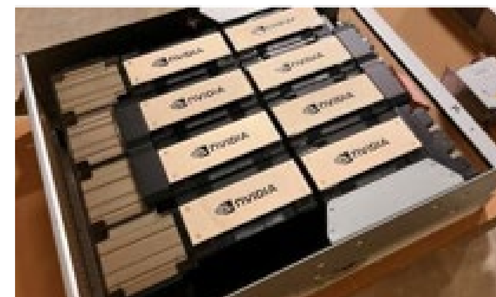
▲2023年10月：石狩データセンターでのGPUサーバセットアップの様子
